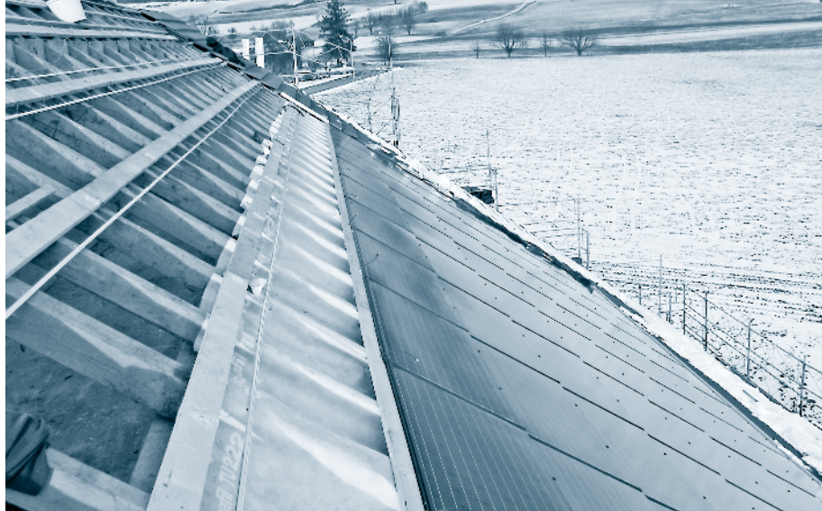
Photovoltaikanlage auf dem Gutsbetrieb des BBZN Hohenrain
